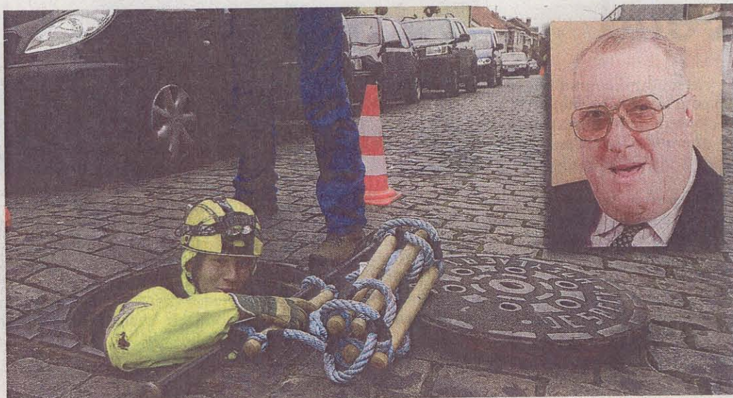
Georges Flagothier avait été à l'origine de l'égouttage dans sa commune.
